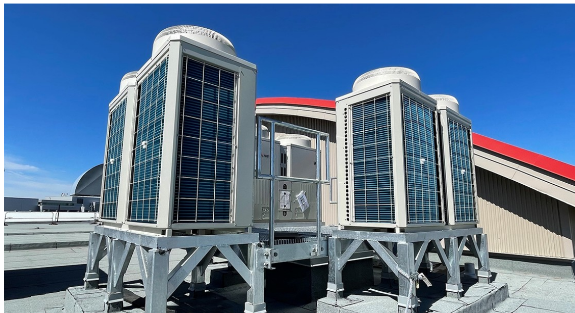
Trois thermopompes ont été installées sur le toit du centre de conditionnement physique de la BFC Bagotville pour améliorer l'efficacité énergétique du bâtiment.
